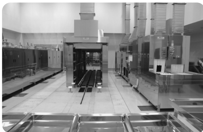
▲食器食缶コンテナ洗浄室
