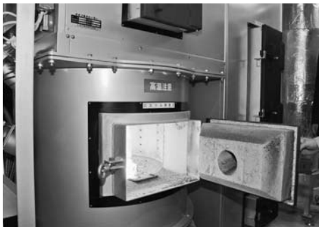
▲木質ペレットで稼動するボイラー
