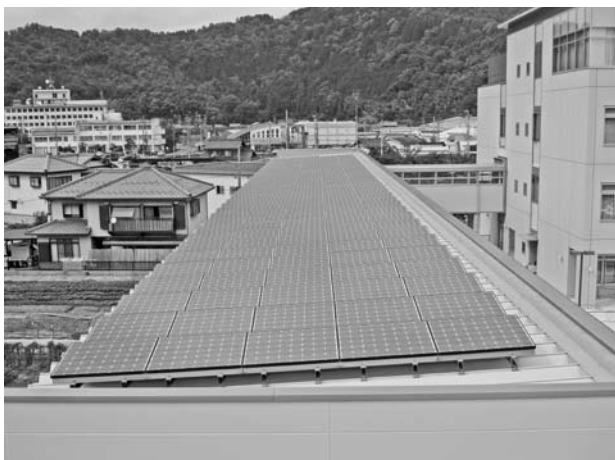
▲太陽光発電システム（車庫棟屋根に設置）
