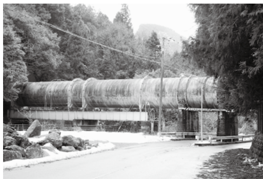
▲久瀬ダムから久瀬発電所への導水管
