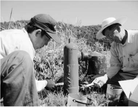
▲真っ赤に蘇った消火栓 (北方)
