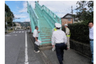
③階段のステップ幅が狭く、冬期降雪時等転倒の危険
