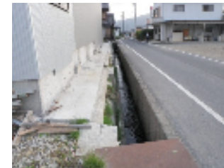
④開水路の落差が高く転落の危険
