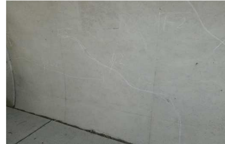
アーチ部のひび割れ
