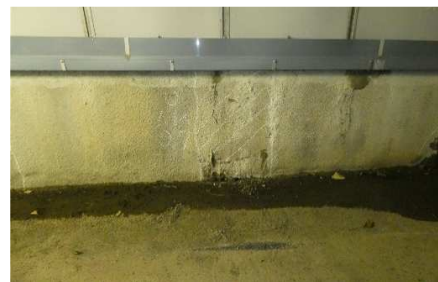
側壁部のうき
