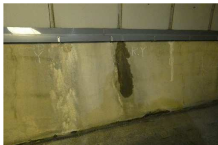
側壁部の漏水
