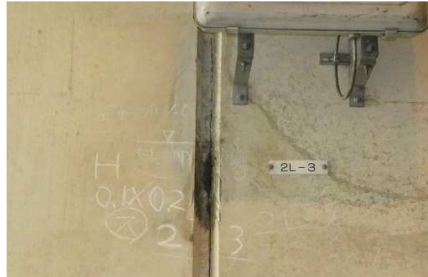
アーチ部のうき・はく離
