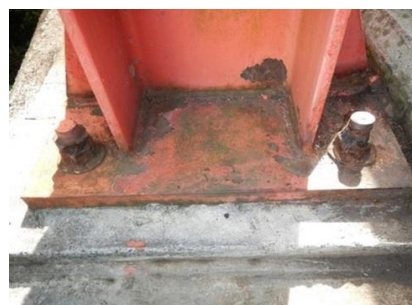
支承部ボルトの腐食
