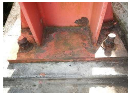
支承部ボルトの腐食
