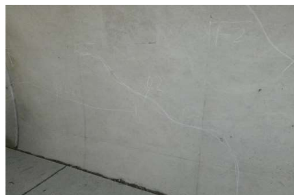
アーチ部のひび割れ
