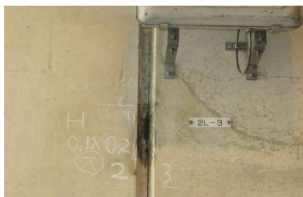
アーチ部のうき・はく離
