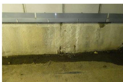
側壁部のうき
