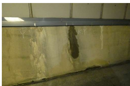
側壁部の漏水
