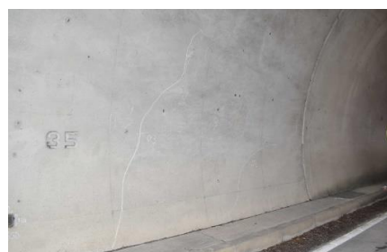
アーチ部のひび割れ
