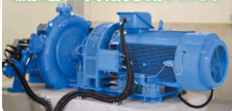
▲下辻南清流発電所 発電機（水車）
