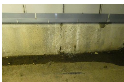
側壁部のうき
