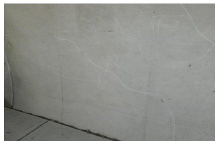
アーチ部のひび割れ
