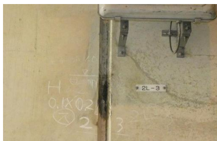
アーチ部のうき・はく離
