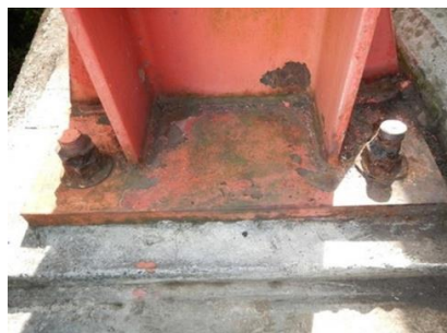
支承部ボルトの腐食
